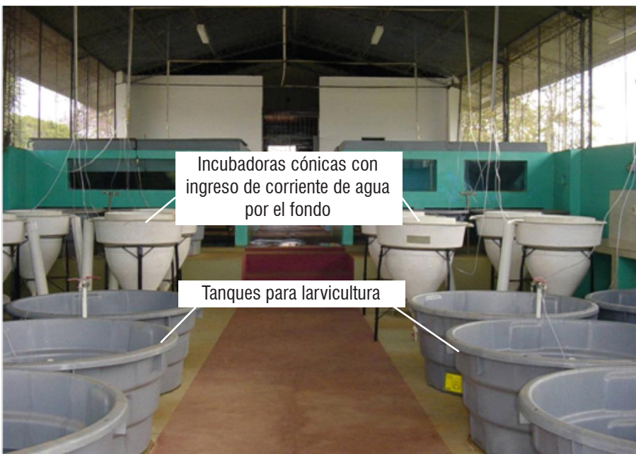
Foto N° 13. Infraestructura requerida para la reproducción artificial de peces.
