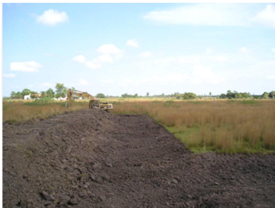
Foto Nº 9. Inicio de la excavación de un estanque piscícola. Nótese el suelo negro característico de alta presencia de materia orgánica.
