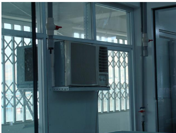
Figuras 3. Instalación de Aire acondicionado en la sala de larvas del LIM
